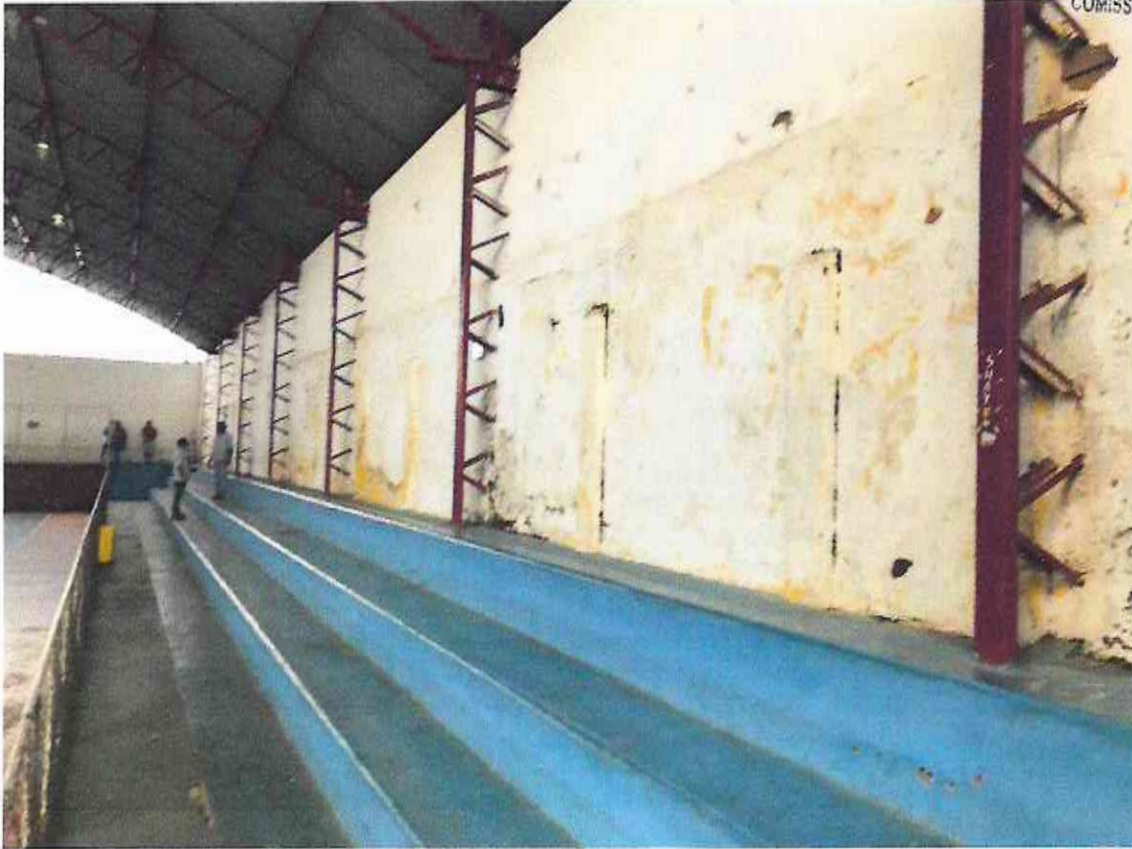
REBOCO COM PATOLOGIA
